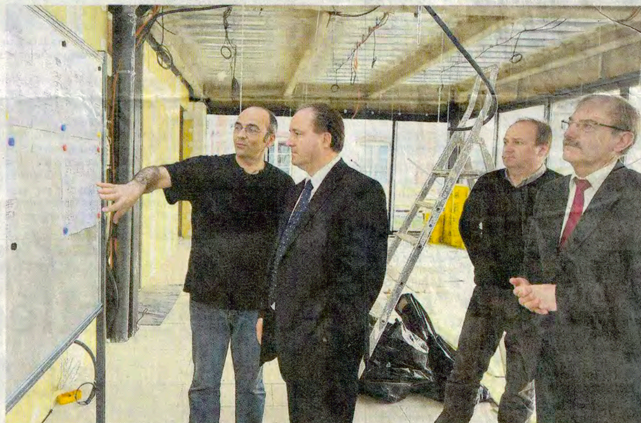
Les responsables du centre hospitalier et le cabinet d'architectes Weber-Keiling ont invité le maire de Haguenau et président du conseil d'administration de l'hôpital à une visite de chantier.
